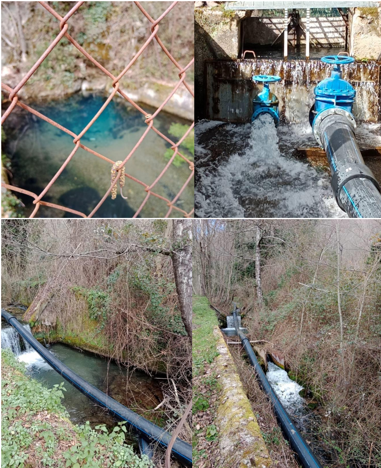
SORGENTE SANTINO MONACO CON CAPTAZIONE REALIZZATA DAL CONSORZIO DI BONIFICA 23.02.2025
